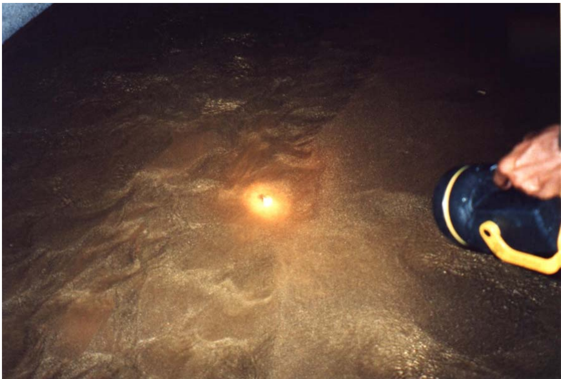
Fotografia 5: Setor da galeria de inspeção e drenagem alagado e com material carregado no fundo em 10/02/2004
